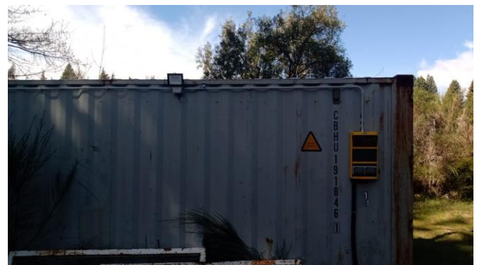
Reflectores y tablero eléctrico ubicados en el patio del monoblock 5.
